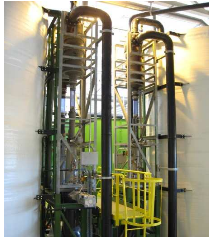
Abb. 3: BTA ® Gritabscheidung MBT Suldoiro, Portugal
