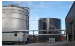
Bioabfallvergärungsanlage Toronto Dufferin Kanada (IBN 2002)
