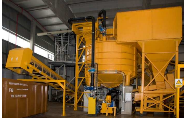
Abb. 2: BTA ® Abfall Pulper, Bioabfallvergärungsanlage Granollers, Spanien © Infoenviro
